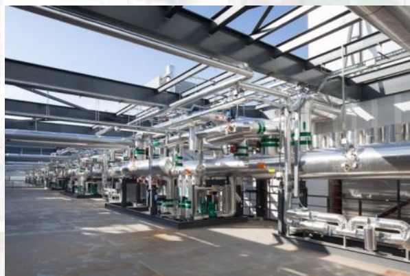
Instalaciones de climatización
